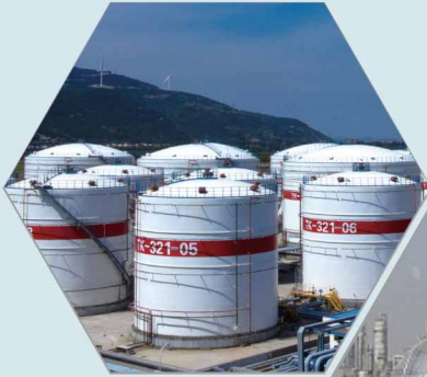
立罐喷淋 冷却系统
